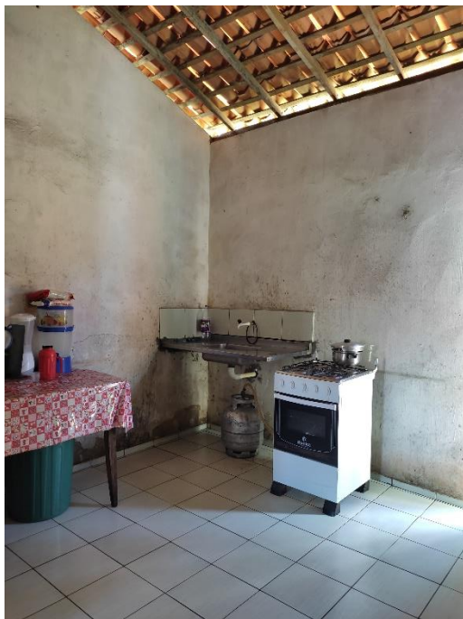
Figura 3 – Rachaduras e reboco descascando:
