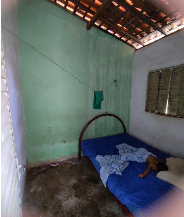
Figura 11 – Sinais de escoamento de água na parede e piso desnivelado:
