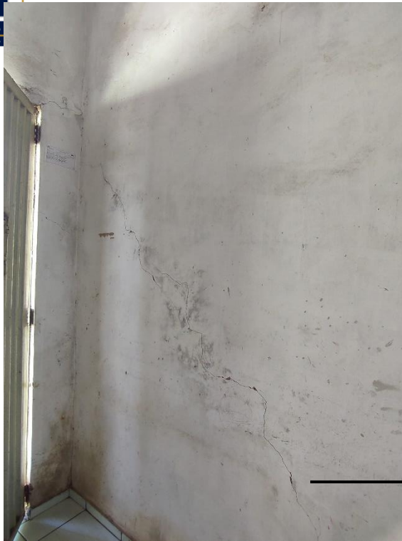
Figura 3 – Fissura na alvenaria:
