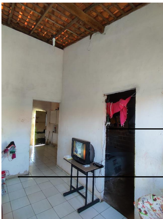
Figura 2 – Fiação elétrica antiga e exposta:
